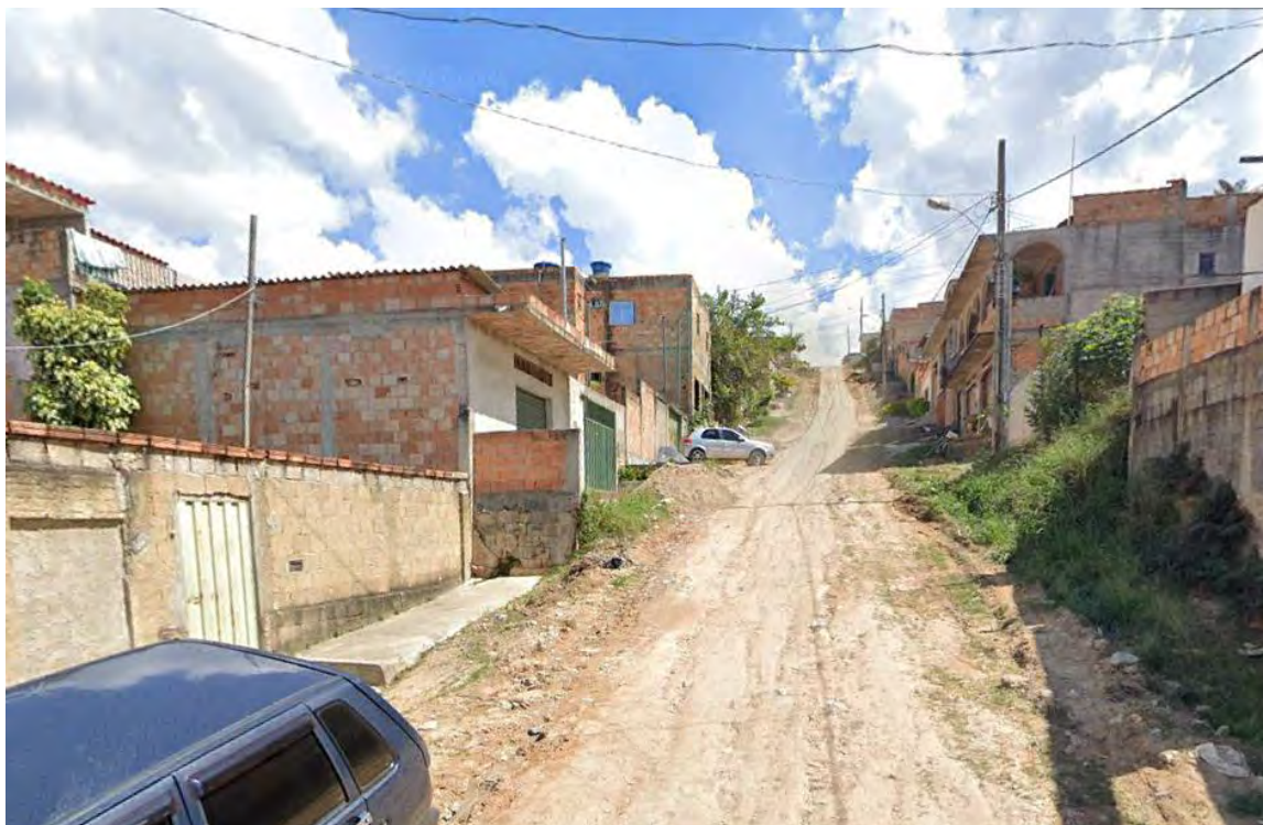
Imagem 84 - Caso pontual de ausência de pavimentação, neste caso, no Bairro Três Corações. Foto: Google Earth, abril de 2019.
